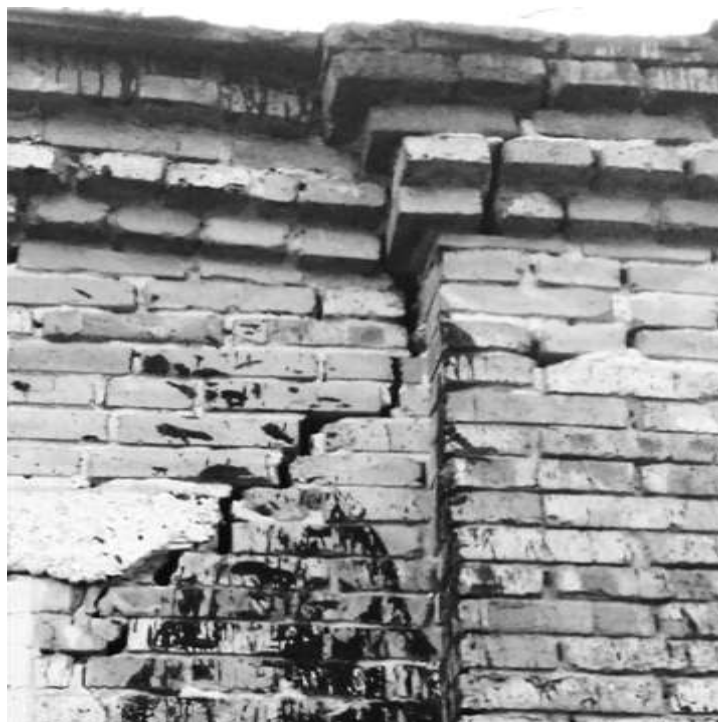
Рис. 2. Трещины в кирпичной кладке
